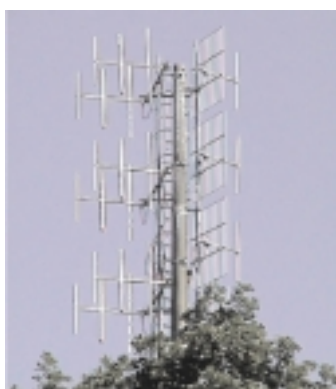
Figura 4 – Sistemi radianti FM
